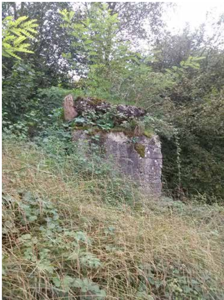
Resti di uno dei plinti di sostegno della stazione di Vigolo Baselga, visibile dalla Strada Statale. Foto a cura dell'autore Aldo Gottardi.
